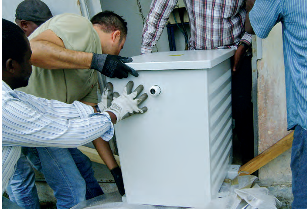
تركيب محوّل جديد في محطة رصد النويدات المشعة RN13 في إيديا (الكاميرون)
