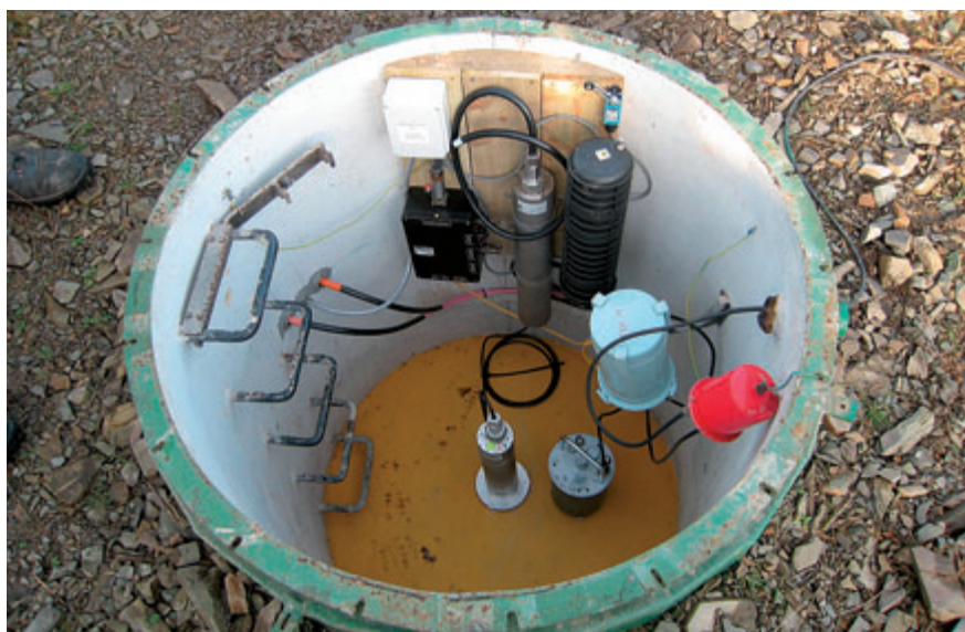
L'un des puits à instruments qui composent la station du réseau auxiliaire de surveillance sismologique AS104 située à Eskdalemuir (Royaume-Uni).
