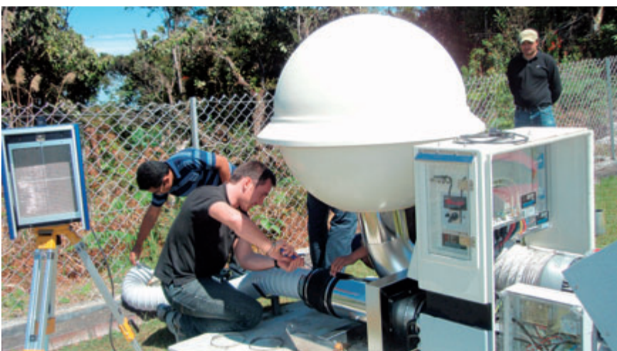
Station de surveillance des radionucléides RN42 située à Tanah Rata (Malaisie).
