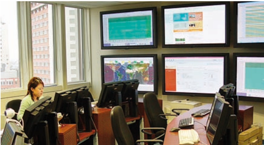
运行中心控制室。
