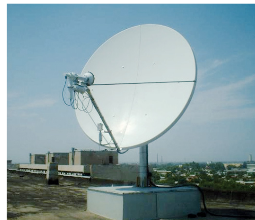
Centre national de données, Tachkent (Ouzbékistan).
