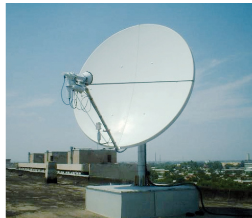
国家数据中心, 乌兹别克斯坦塔什干。
