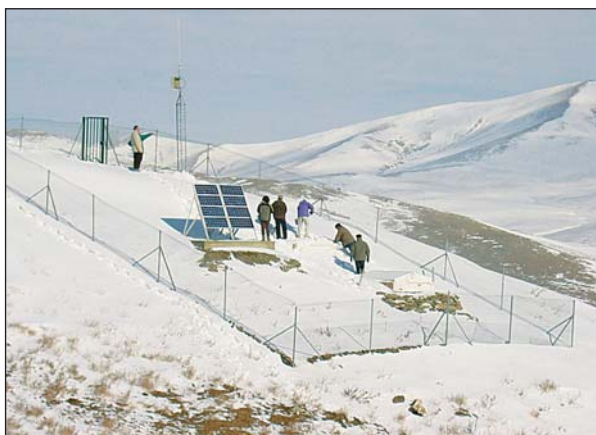
Station PS25 du réseau primaire de surveillance sismologique (Songolo, Mongolie)
