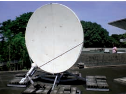
VSAT antenna at AS80, Tagaytay, Luzon, Philippines.
